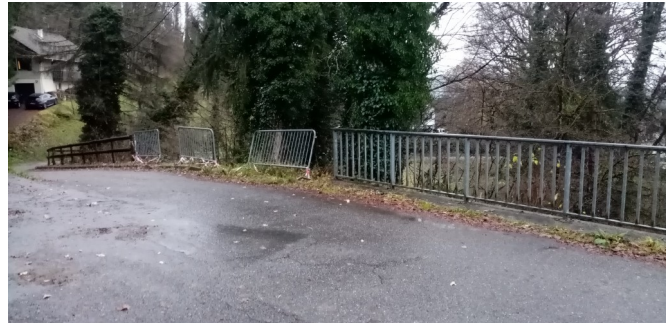
Barrière cassée, Chemin de Coulé
