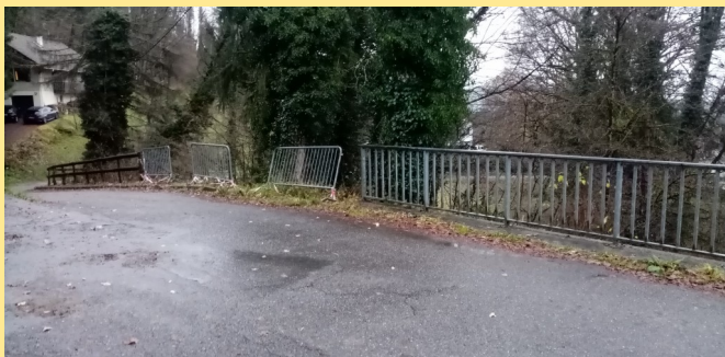
Barrière cassée, Chemin de Coulé
