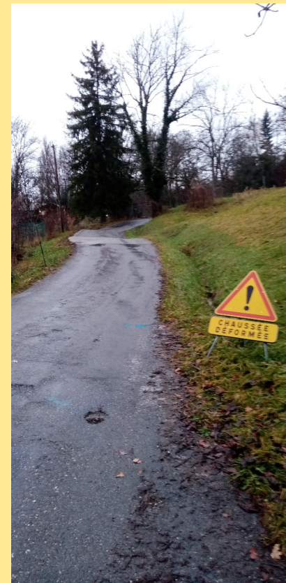
Chaussée déformée, Route des Farnaises
