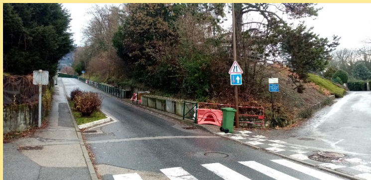
Eboulement du talus, Vi de Chenaz
